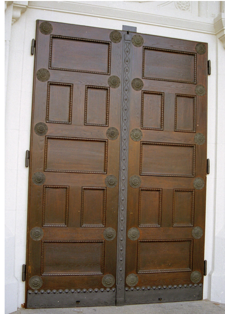
Hauptportal mit Türbeschlägen - vor der Restaurierung
