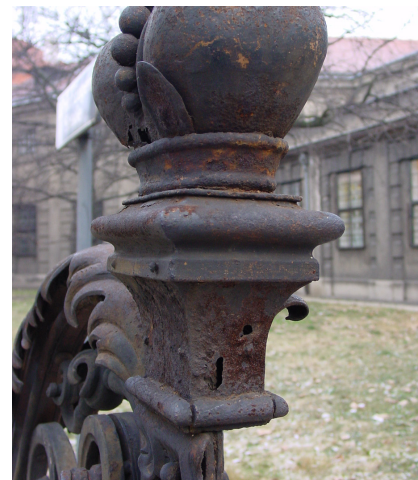
von Korrosion durchwanderte Fassung, abkorrodierte Teile - vor der Restaurierung
